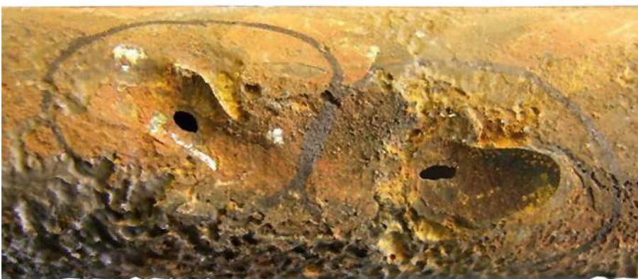
Abb. 8: Schadenbild Wasserstoffkorrosion an einem Stahlrohr, verursacht durch Schwefelsäure
