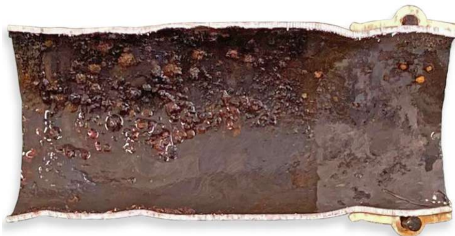
Abb. 6: Schadenbild Sauerstoffkorrosion an der Innenseite von einem Stahlrohr
