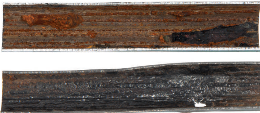
Abb. 12: Schadenbild Flächenkorrosion an einem Rohr aus Kohlenstoff-Stahl. Bild oben: Ansicht des Rohrs mit den Korrosionsprodukten. Bild unten: Das von den Korrosionsprodukten gereinigte Rohr
